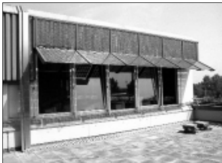
Abb. 1: PV-Fassadenanlage mit Verschattung der dahinterliegenden Ausbildungsräume.
