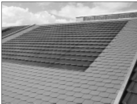
Abb. 2: Integration von PV-Dachziegeln in den Ausbildungsdachstand auf dem Gebäude »Butzweilerhof«.
