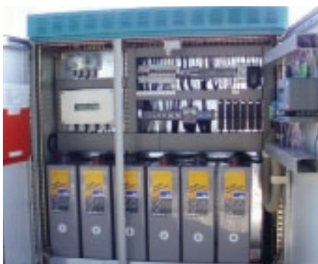
Abb. 3: Schaltschrank zur Aufnahme von Energiespeicher und Steuerelektronik. Auf dem Dach ist der Wärmetauscher für die Batteriekühlung zu sehen. Er wird mit Überschuss-Strom versorgt.
