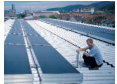
Abb. 2: Solarluftkollektoranlage auf dem Dach der IHK Südlicher Oberrhein.
