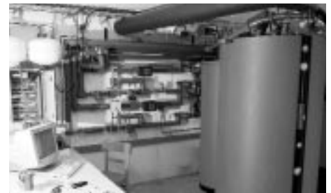
Abb. 2: Sorptionspeicher im Solarhaus Freiburg. Die Abbildung zeigt zwei mit Sorptionsmittel gefüllte Behälter und einen Wasserbehälter, in dem zugleich der Verdampfer und Kondensator untergebracht sind.
