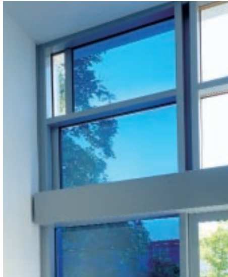
Abb. 1: Testfassade mit eingefärbten und entfärbten schaltbaren (gaschromen) Fenstern am Fraunhofer ISE.
