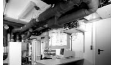
Abb. 1: Teststand für Lüftungs-Kompaktgeräte im Solarhaus Freiburg.
